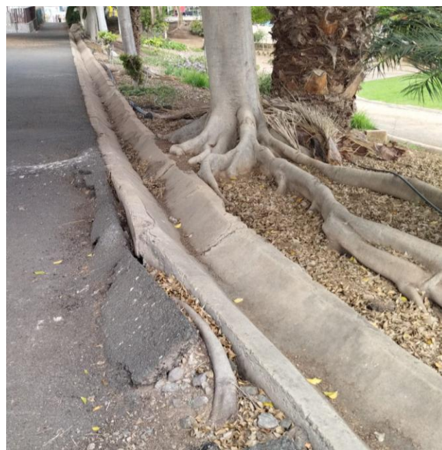
Fig. 35: Pavimento levantado y apoyado en el reguero/acequia que se observa en la foto. Fuente: Elaboración propia en el Parque de la Mayordomía, LPG.
