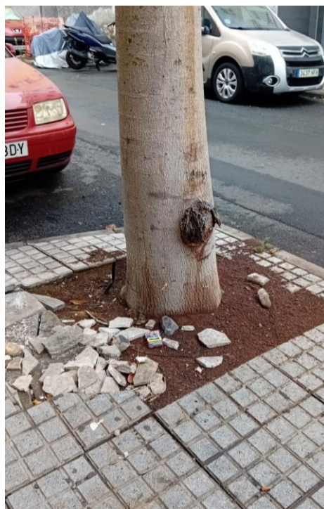
Fig. 57: Herida provocada por el golpe continuado de los vehículos al aparcar. Fuente: Elaboración propia en la Calle Mariucha, LPG.
